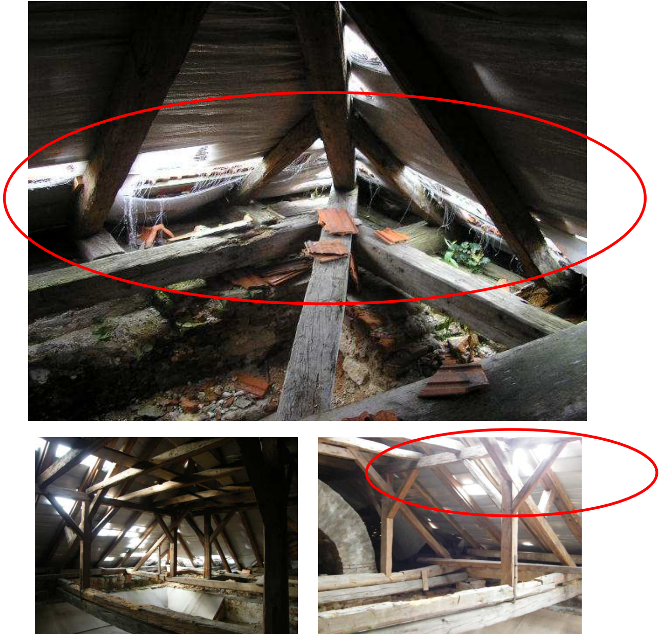
Obr. 4-6 poruchy strešného plášťa
